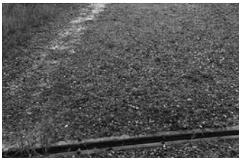
Das Herbizid gelangt hier via Entwässerungsrinnen in die Kanalisation.
