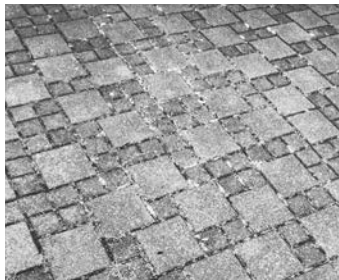
Applizierte Herbizide können durch das Kopfsteinpflaster ungehindert in Gewässer dringen.
