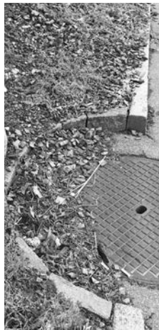
Der Einsatz von Herbiziden neben einer Dole begünstigt einen Eintrag in die Kanalisation.
